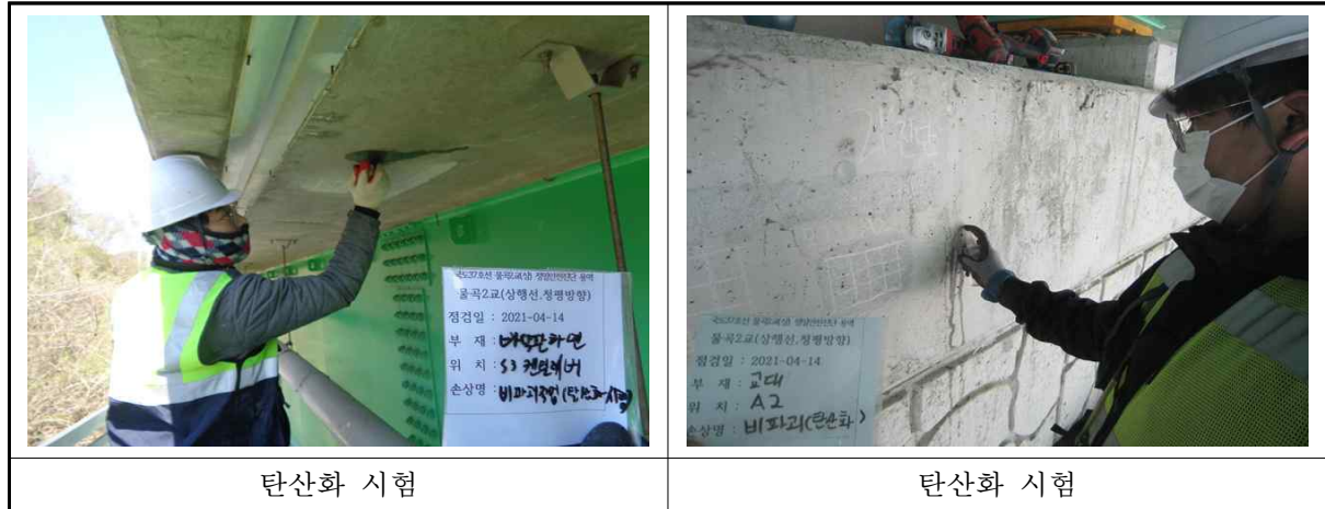
<사진 3.26> 탄산화 현황
